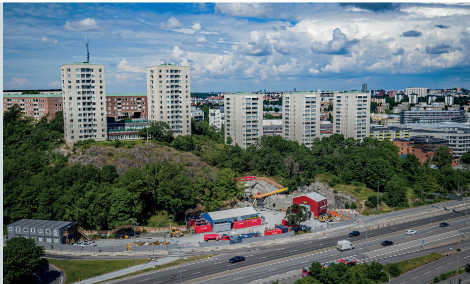
Från etableringen vid Södertäljevägen har vi byggt en 400 meter lång arbetstunnel under Nybohovsberget. Avloppstunneln drivs nu fram åt två håll ca 38 meter under Mälarens nivå.
