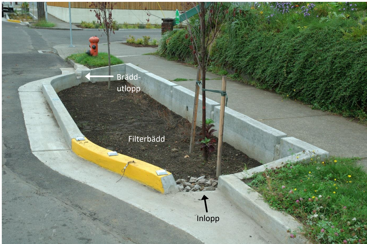
Figur 2 Biofilter med stenskravel som erosionsskydd vid inloppet och bräddutlopp i form av en slits i kantstenen. Filtret är plant och omgivande nivåskillnader tas upp av filtrets sarger.
