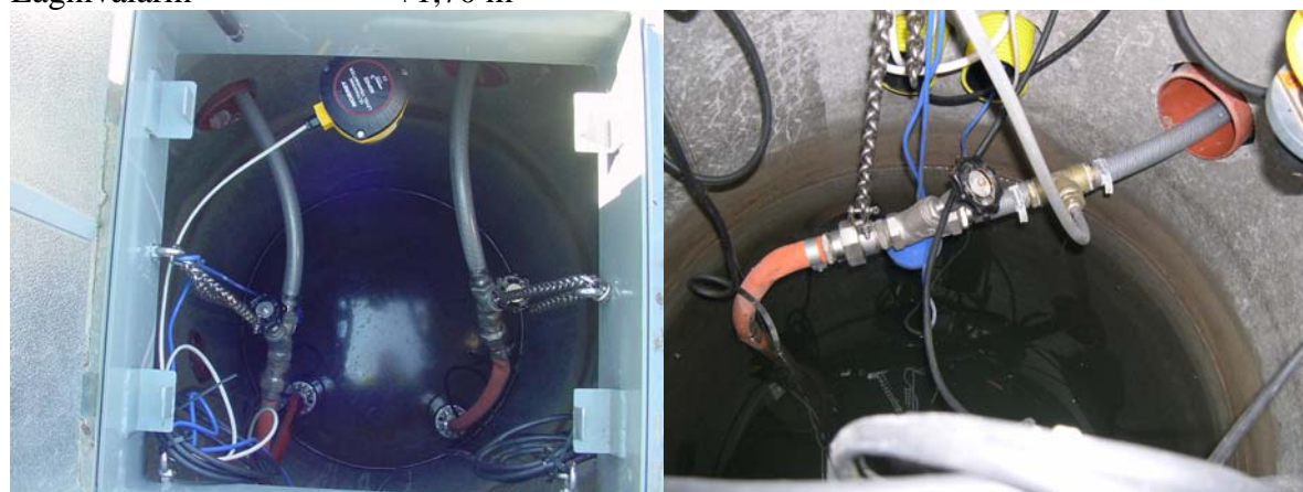
Figur 3.4 Bilder på pumpstationen
