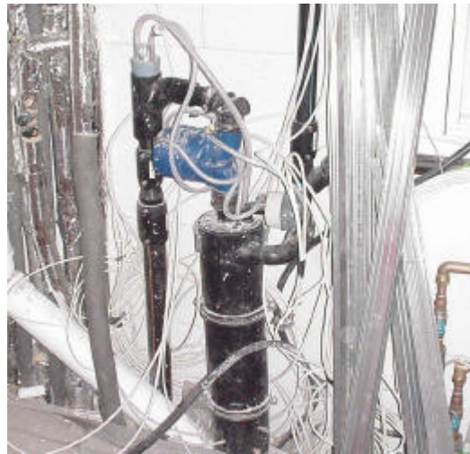
Figur 3. Uppsamlingskammare i anslutning till vakuumtoalett (centralt i bilden). (Foto: Martin Oldenburg, OtterWasser)
